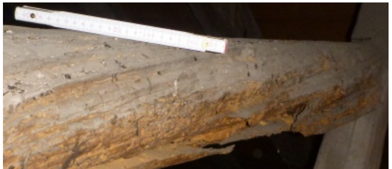
Detail des Kirchendachstuhles, der ebenfalls renoviert werden muss.
